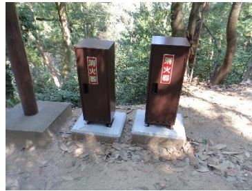
消火施設（消火器）
