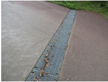
排水設備（暗渠）
