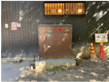
消火設備（消火栓）
