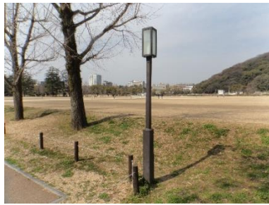
城山公園（堀之内地区）の 園路沿いにある照明施設A
