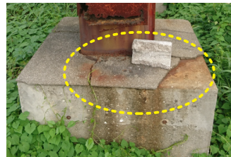
基礎部の劣化
