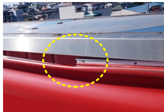
取付金具の破損
