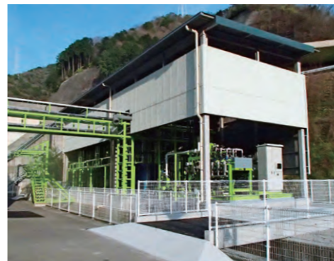
横谷埋立センター エコ次亜設備
