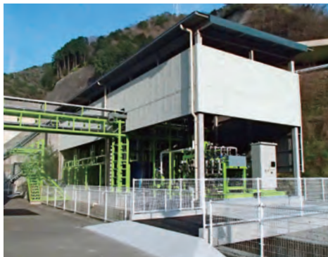
横谷埋立センター エコ次亜設備
