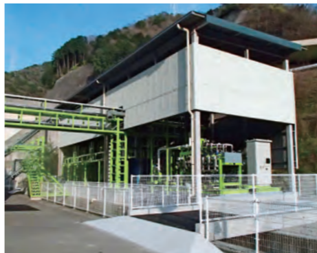
横谷埋立センター エコ次亜設備
