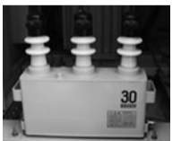
【コンデンサー】(蓄電器)
