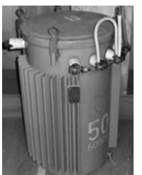
【トランス】(変圧器)
