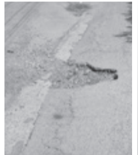
道路の舗装の剥がれ
