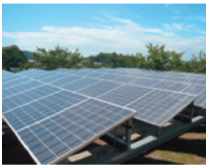
太陽光発電システム
