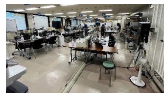
■災害対策室：床上ケーブル配線
