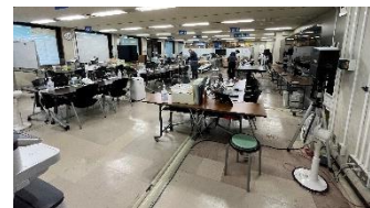
■災害対策室：床上ケーブル配線
