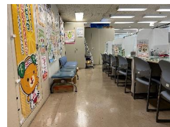
■別館：廊下幅の不足
