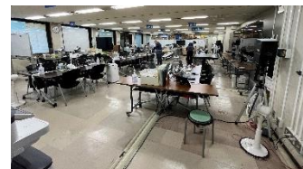
■災害対策室：床上ケーブル配線
