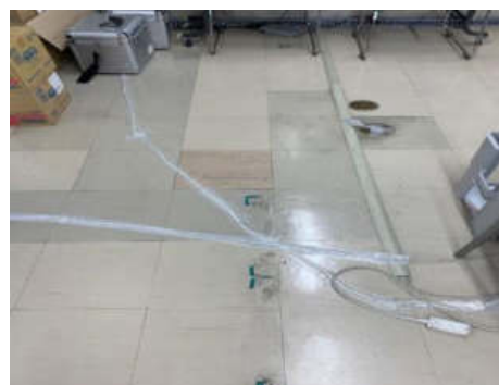
■災害対策室：床上ケーブル配線
