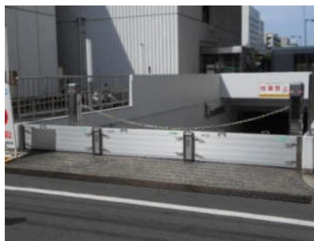
■本館：止水板による浸水対策
