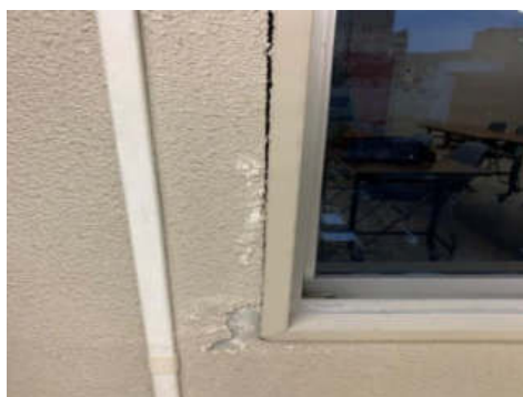
■第4別館の外観と内壁のひび割れ
