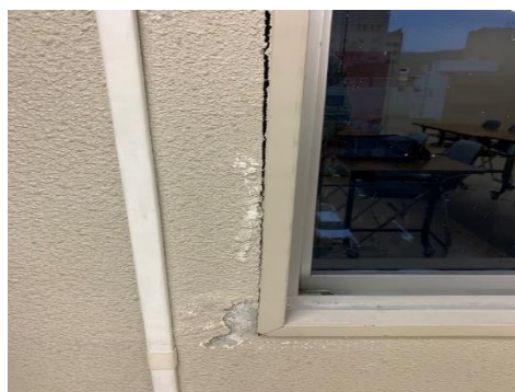
■第4別館の外観と内壁のひび割れ
