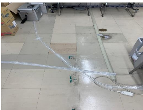
■災害対策室：床上ケーブル配線
