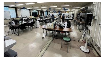
■災害対策室：床上ケーブル配線
