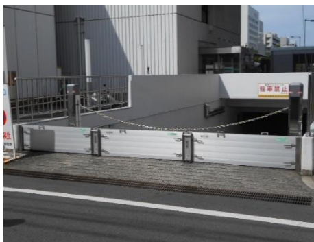
■本館：止水板による浸水対策
