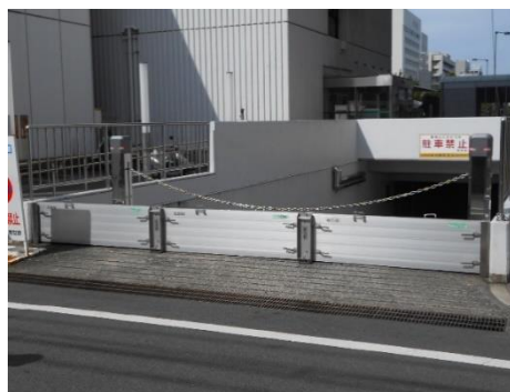
■本館：止水板による浸水対策
