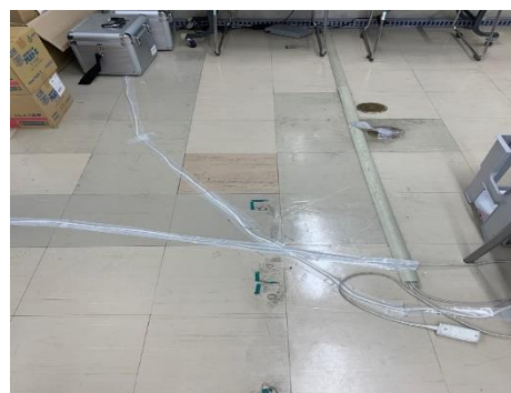
■災害対策室：床上ケーブル配線
