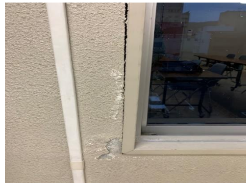
■第4別館の外観と内壁のひび割れ
