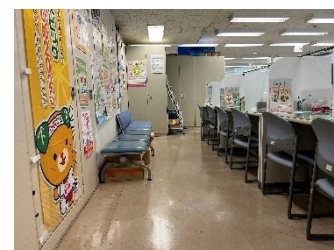
■別館：廊下幅の不足
