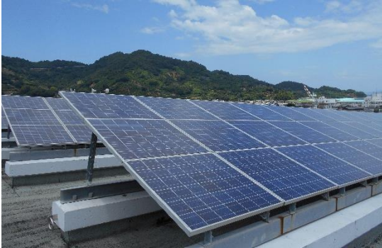
太陽光発電システム
