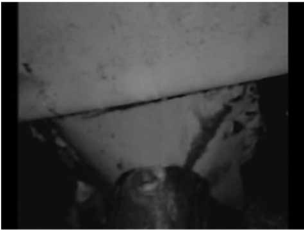
(新玉小学校西横断歩道橋 防鳥パネル内床板腐食)
