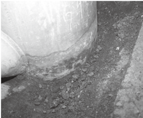
支柱基部の腐食
