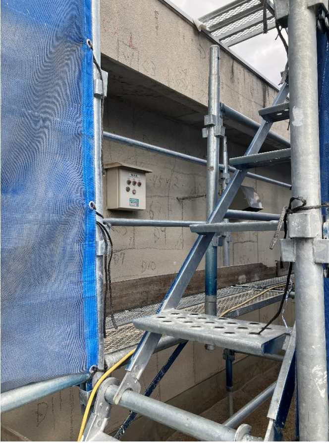
集会所劣化部調査マーキング
