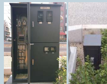
電源設備(イベント等使用可能)
