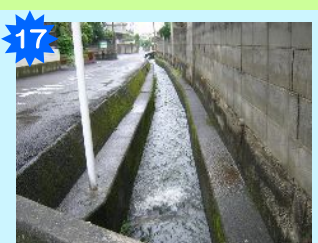
17 紅葉町の水路 通学路横にさくのない水路が多い。道も細く、車が通ると水路に落ちそうになることもある。大雨の時は水量も増えて危ない。
