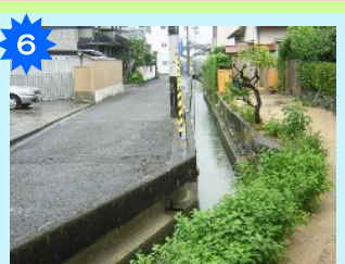
6 石手白石の水路 流れが速く、さくがない。特に水が増えた時に危ない。
