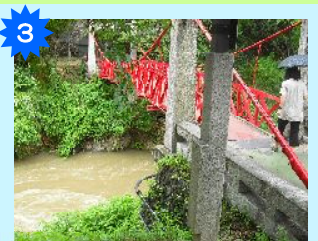
3 赤橋 周辺の道は、手すりやフェンスがなかったり低かったりして、転落の恐れや水の事故の危険がある。石手川の急な増水にも注意が必要。
