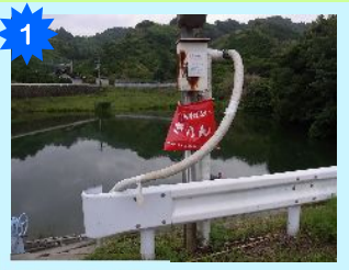
1 石手本谷池 水門操作のため、水面まで下りていくことができる階段がある。周囲はひと気が少なく、落ちても助けが呼べない。
