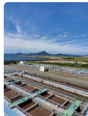
▲下水処理場（西部浄化センター）
