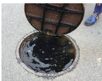
油や異物が詰まると逆流してマンホールからあふれることも
