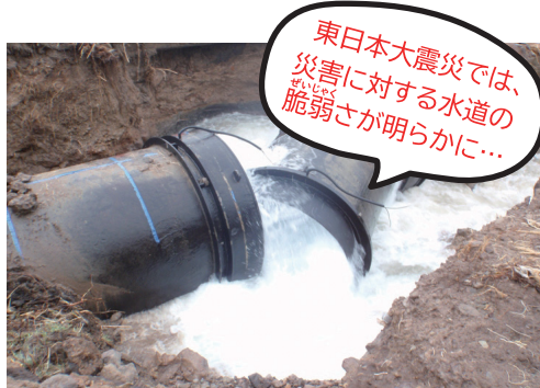
東日本大震災で破損した水道管 (写真提供元:宮城県企業局)
