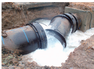
地震による水道管の破損 写真:宮城県企業局提供
