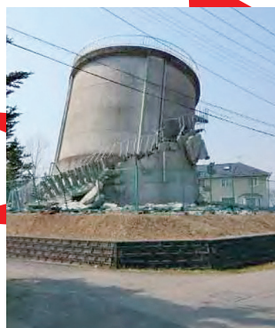
倒壊した配水池
