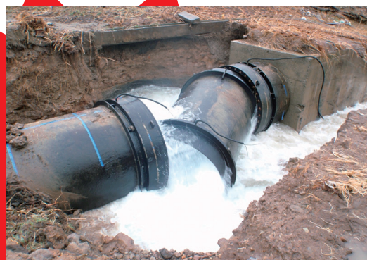
つなぎ目が外れやすい構造の水道管から水漏れが発生
