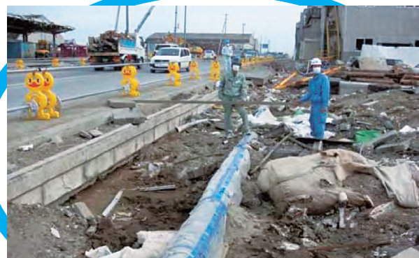
つなぎ目が外れにくい構造の水道管では水漏れがなかった
