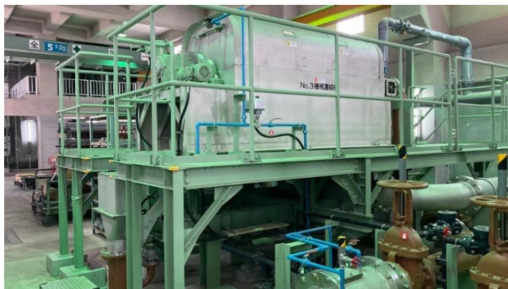
▲更新した汚泥濃縮機
