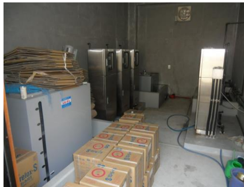
▲更新する設備
