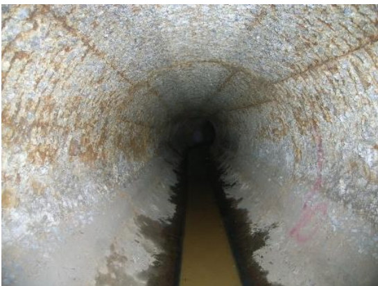
▲老朽化した管渠
