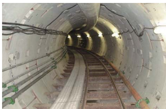
雨水幹線（朝生田地区）
