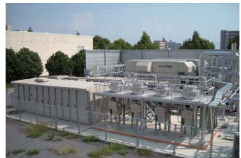
消化ガス発電設備
