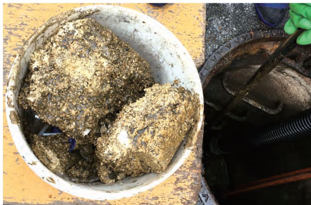
下水道管内で固まった油
