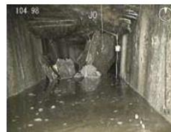
図 1 地下水路の破損状況
