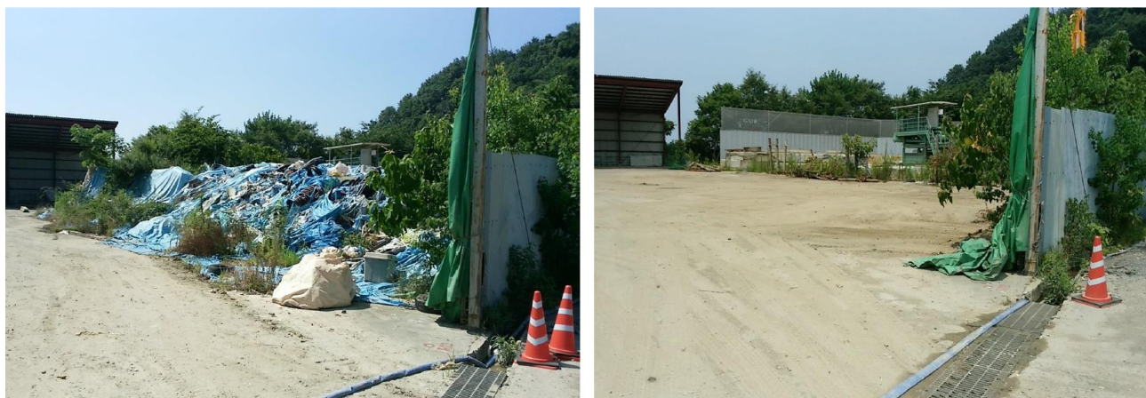
写真 6・2-1 原状回復支援事業に基づく行政代執行を行った旧中間処分施設
