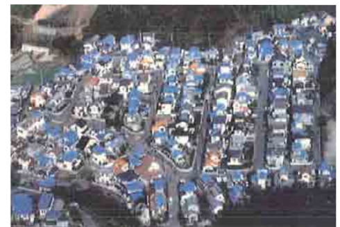
伊予地区における屋根瓦の損壊状況(ブルーシートによる応急処置)
