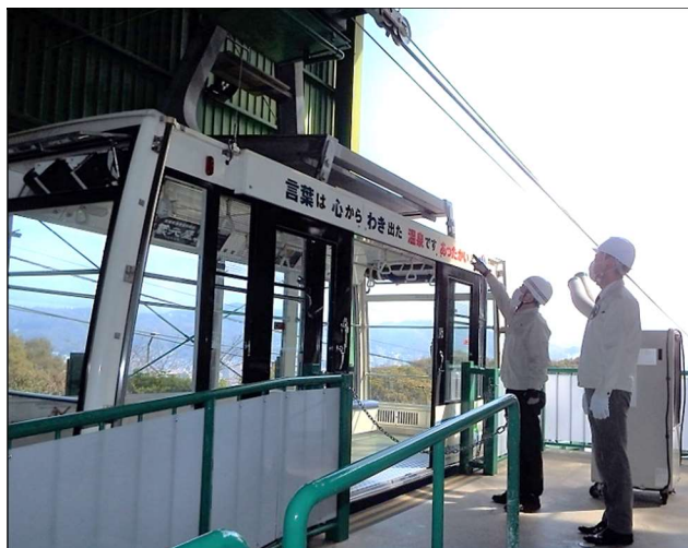
安全統括管理者(左)による設備巡視
