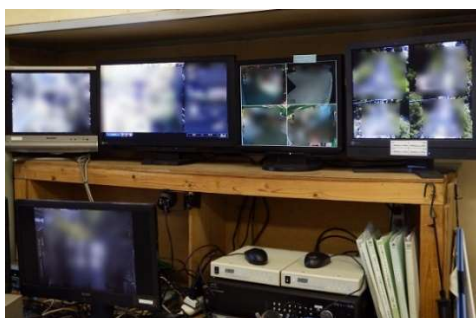
運転室内の監視カメラモニター(保安上の理由で画像を一部加工しています)
