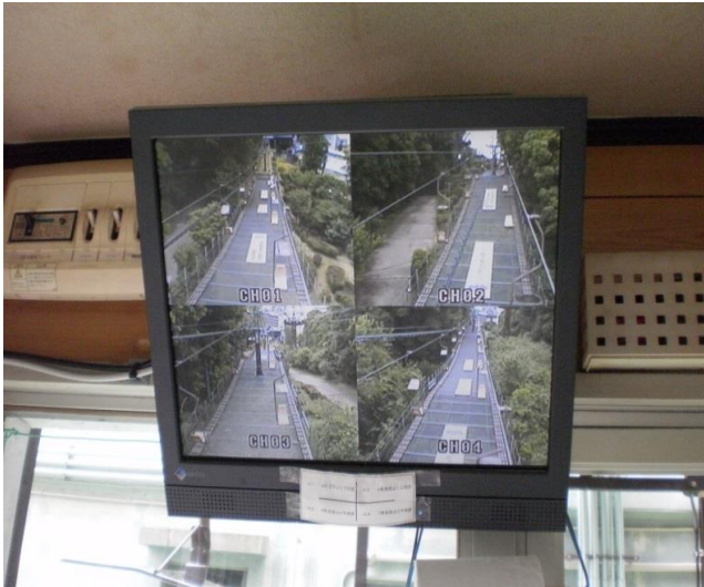
リフト監視室に設置されたモニターTV
