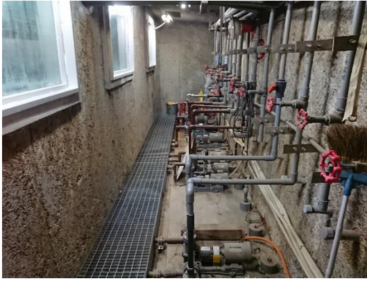
第 5 分湯場内部 ポンプ室
