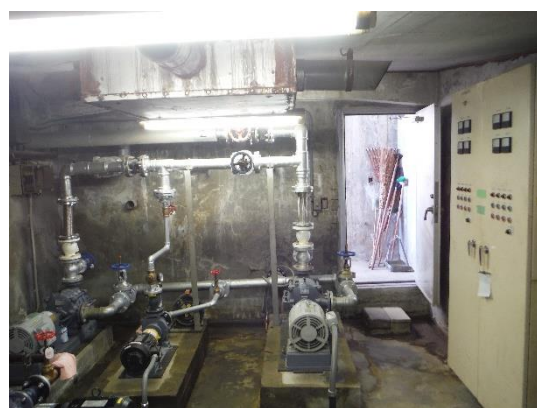
14・15・24号源泉ポンプ室内部
