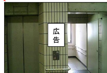
⑥1階エレベーター扉横掲出場所
