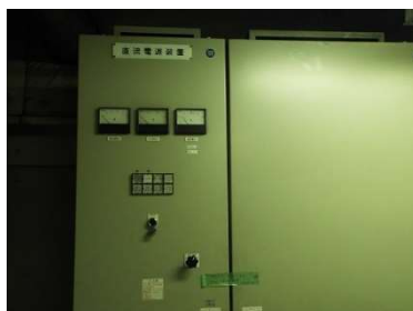
【電気室（直流電源装置の故障）】
