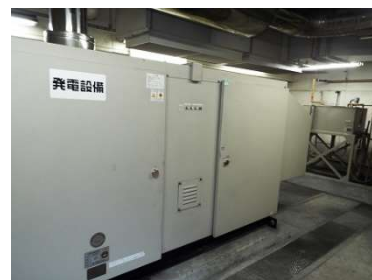
【電気室（非常用発電機の劣化）】
