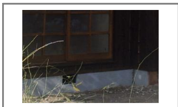
コンクリート基礎等（評点 0）
