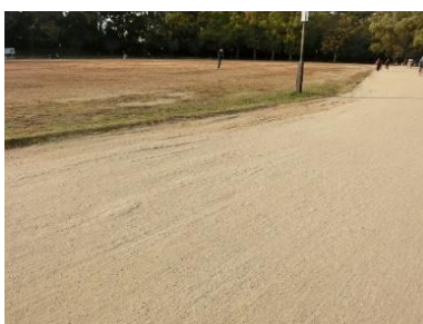
道路遺構（園路）の劣化状況
