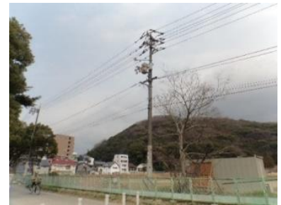
電柱（四国がんセンター跡地）
