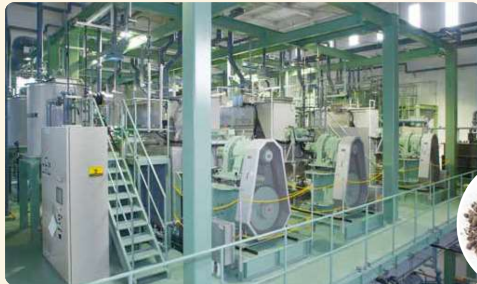
汚泥脱水機 汚泥を汚泥脱水機で含水率70%以下まで脱水し、助燃剤化します。脱水汚泥(助燃剤化)は、松山市西クリーンセンターで焼却します。
