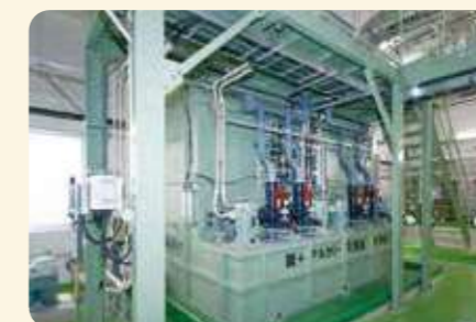
酸+アルカリ・次亜塩洗浄塔 薬液洗浄により臭気成分を除去します。
