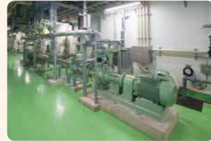
破碎機 し尿・浄化槽汚泥中のごみを小さく破碎します。
