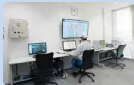
中央監視室 施設の運転状況をリアルタイムで監視・制御します。
