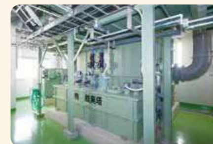
生物脱臭塔 高濃度臭気を生物分解し、臭気成分を除去します。
