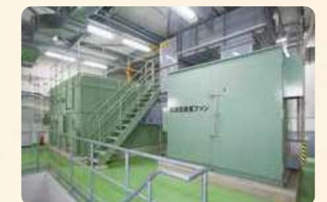
活性炭脱臭塔 活性炭により臭気成分を除去し、屋外へ放出します。
