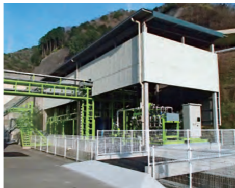
横谷埋立センター エコ次亜設備
