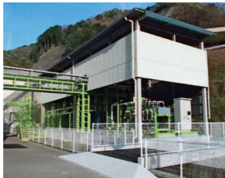
横谷埋立センター エコ次亜設備
