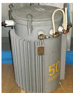
トランス（変圧器）
