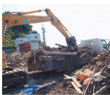
西クリーンセンターに搬入される松野町の災害廃棄物
