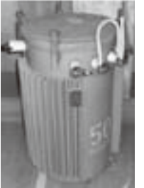
トランス(変圧器)
