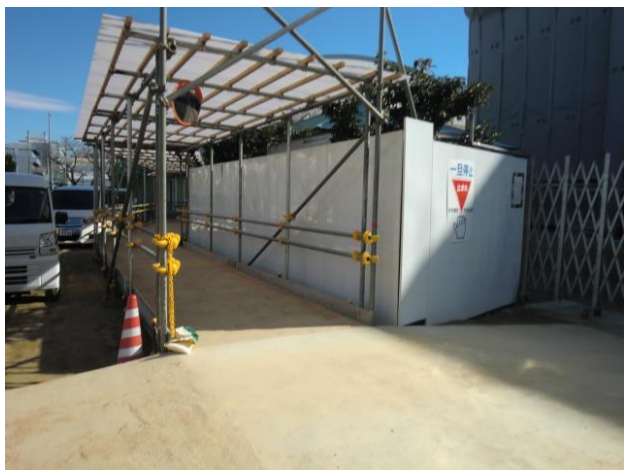
仮設安全通路
