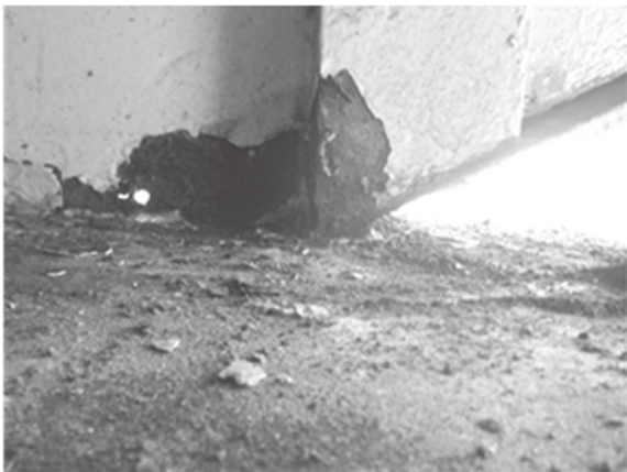
バスターミナル東横断歩道橋 支承付近の階段部主桁で腐食
